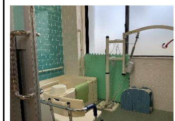
↑個別浴槽（昇降リフト付き）
