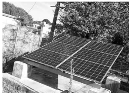
中部資源回収ステーションの太陽光発電所
