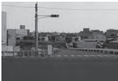
県道豊田知立バイパス線交差点からみよし市との境までの区間工事中
