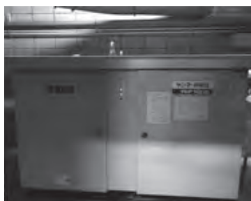
本町に設置されている非常用電源装置
