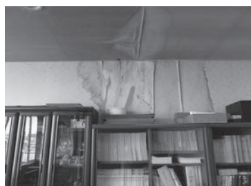
雨漏りがひどい庁舎4階 議員控え室
