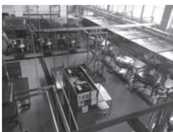
空調がない給食センター
