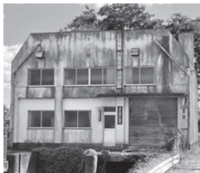
春木・四ツ塚地域にある「春木排水機場」
