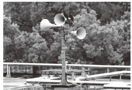
音貝小学校の防災行政無線のスピーカー
