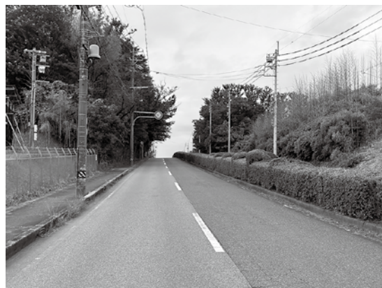
陥没する恐れのある道路
